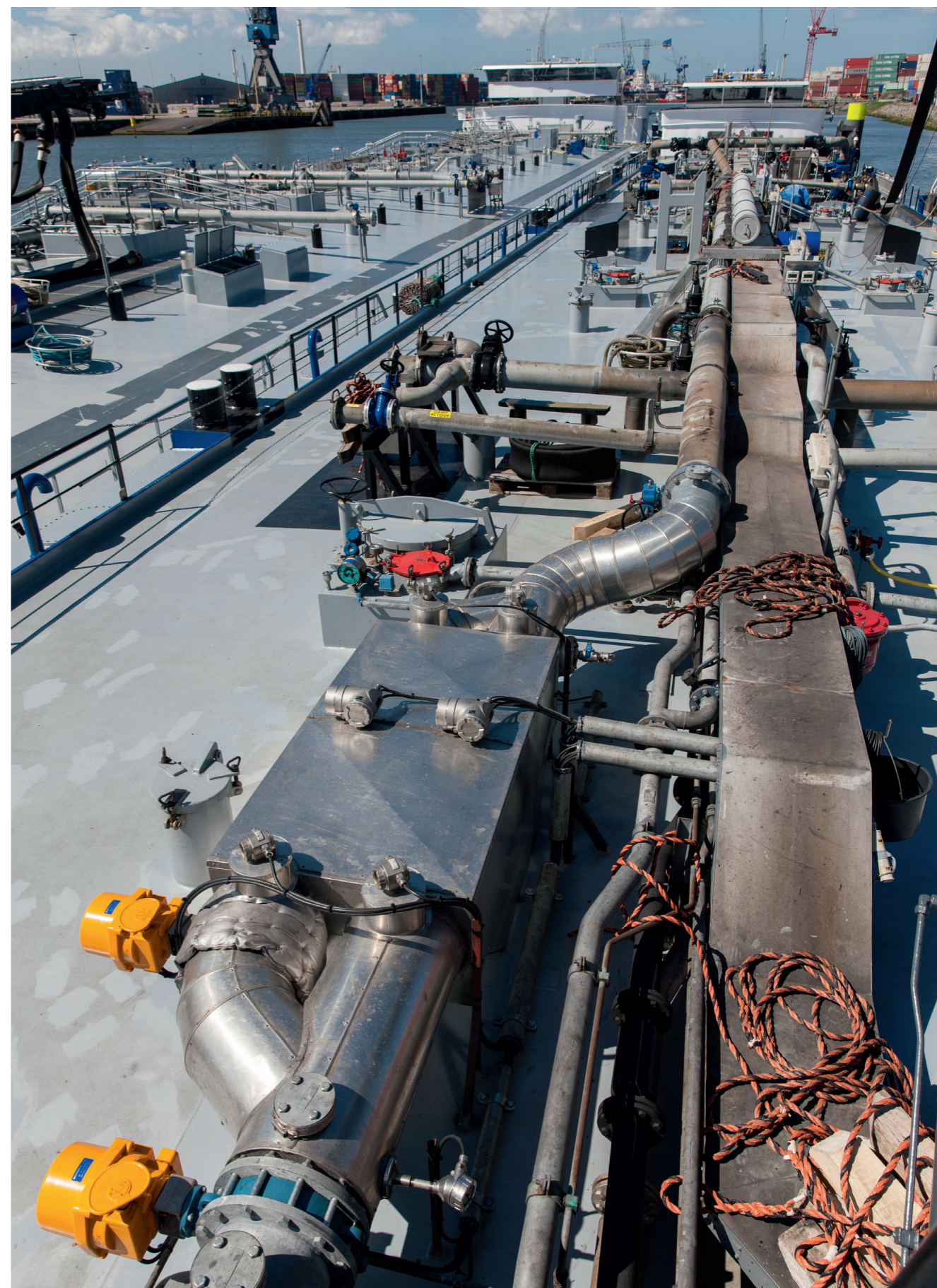
Het Endress+Hauser bunkermeetsysteem - hier als tweekanaals installatie voor uitgebreide turndown - bestaat uit verschillende meetapparatuur voor debiet, druk en temperatuur, waardoor een transparant en betrouwbaar bunkerproces wordt gegarandeerd.
